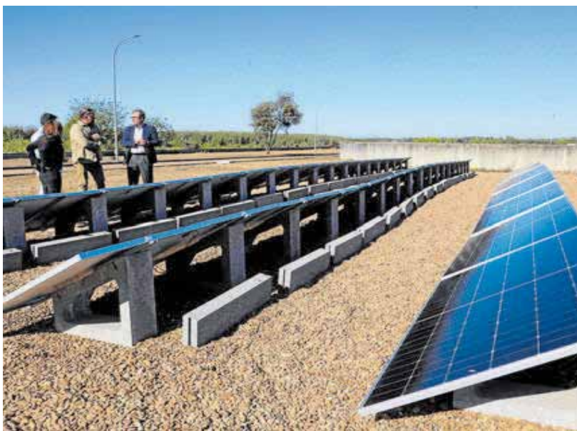
El alcalde de Mérida visita la instalación solar en la planta de el Prado. J. M. ROMERO
